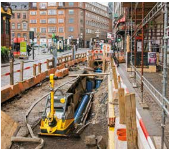
I 2022 blev 123 km ledninger gravet op og renoveret. Deres gennemsnitsalder var cirka 20 år lavere den forventede levetid. Foto: Colourbox.dk
